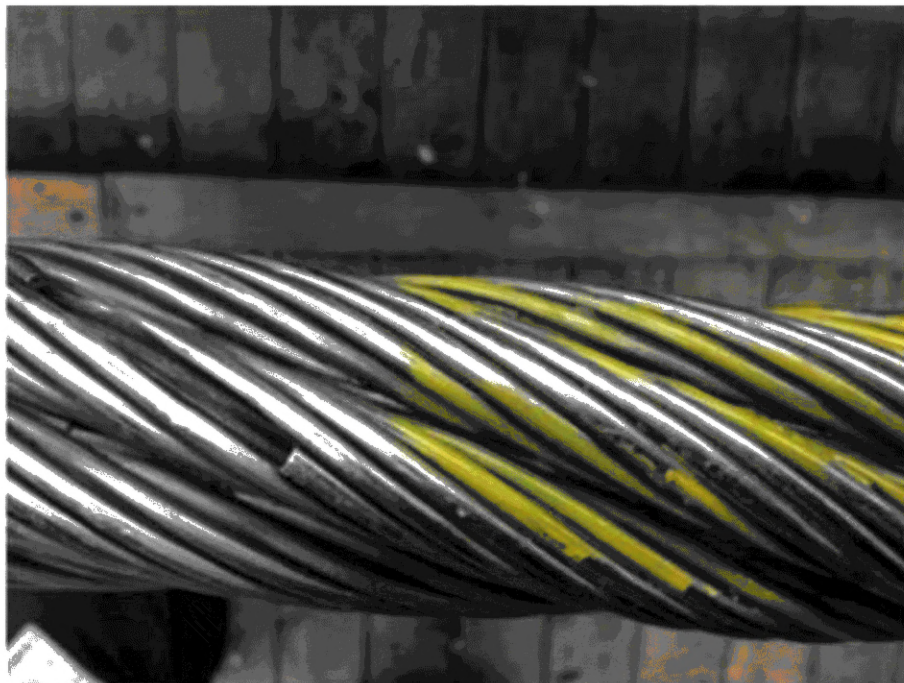
Рисунок А.1 — Обрывы наружных проволок несуще-тягового каната
