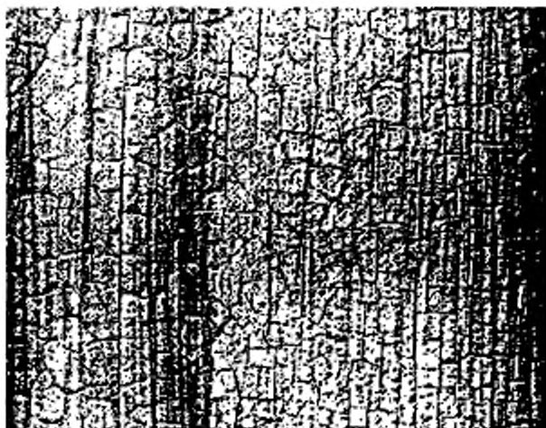
Рисунок 1 — Растрескивание лакокрасочного покрытия
