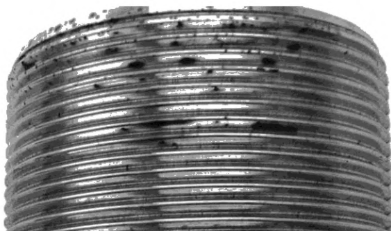
б) Следы коррозии на наружной резьбе
